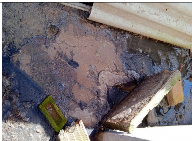
Autor: Reclamante Descrição: Transbordamento de esgoto na residência da reclamante, datada 21/01/2023.
