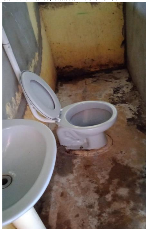
Autor: Reclamante Descrição: Transbordamento de esgoto na residência da reclamante, datada 21/01/2023.
